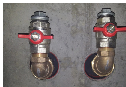
2 Kugelhähne nach Wanddurchführung als Schnittstelle
