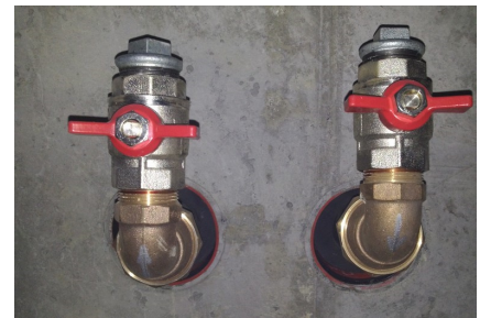
2 Kugelhähne nach Wanddurchführung als Schnittstelle
